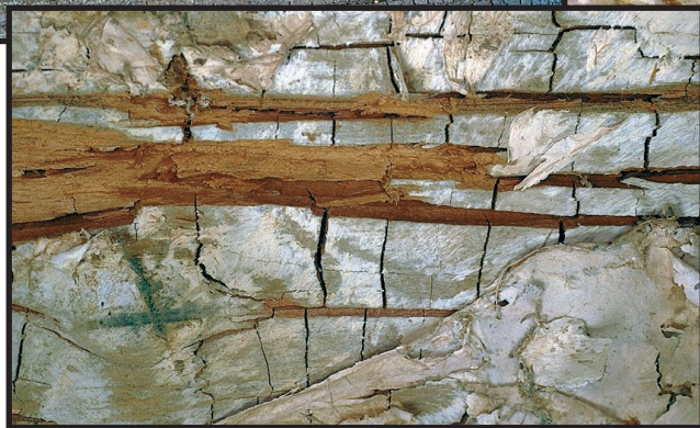
„Svampeskade“ med store sprækkeklodser (brunmuld) og overflademycelium
